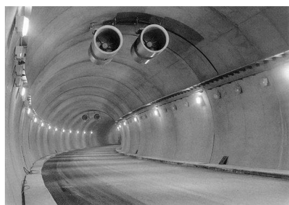
Рис. 2. Установка струйных (осевых) вентиляторов под сводом тоннеля Fig. 2. Installation of jet (axial-flow) fans under tunnel crown
